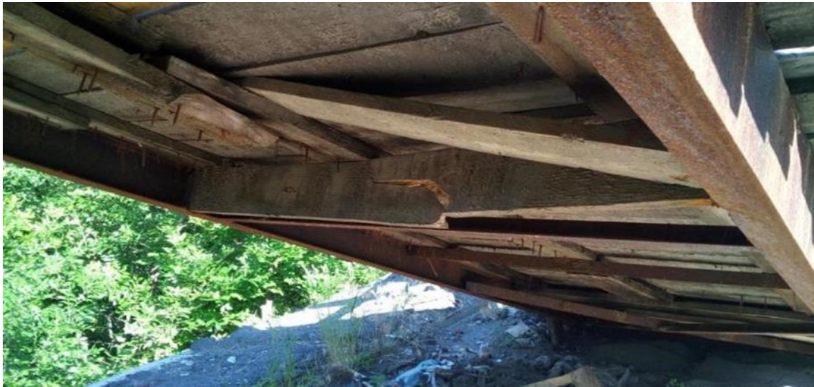
Пошкодження дерев'яної секції мосту в Станиці Луганській, зафіксовані 21 червня
