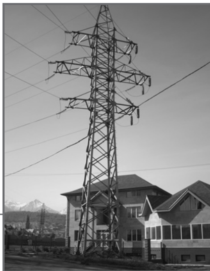
ЛЭП 110 кВ, построенная в микрорайонах Горный Гигант и Городок МВД г.Алматы.
