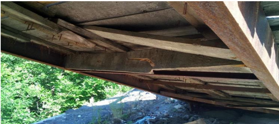
Повреждения деревянной секции моста в Станице Луганской, зафиксированные 21 июня
