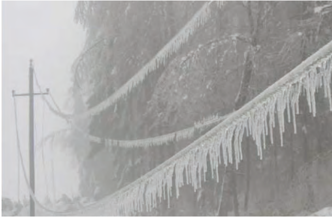
الشكل ٢٥. طبقات الثلج تلحق الضرر بخطوط القوي الكهربائية في مقاطعة كارينثيا في النمسا في شتاء ٢٠١٤.
