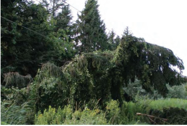
شكل ٢٤. الأضرار التي تلحق بخط القوي الكهربائية بسبب ضغط الرياح
